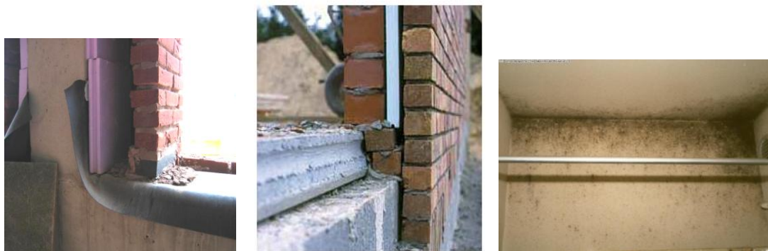
Figure 2.1 Des ponts thermiques sont souvent synonymes de problèmes
